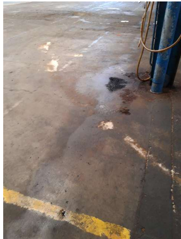
Photographie 5 : Traces hydrocarbonées grasses dans le bâtiment principal
